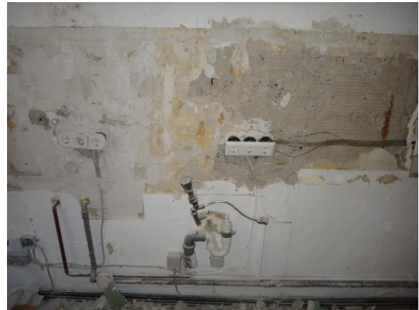
Leitungen liegen frei und sind nicht fachgerecht verlegt
